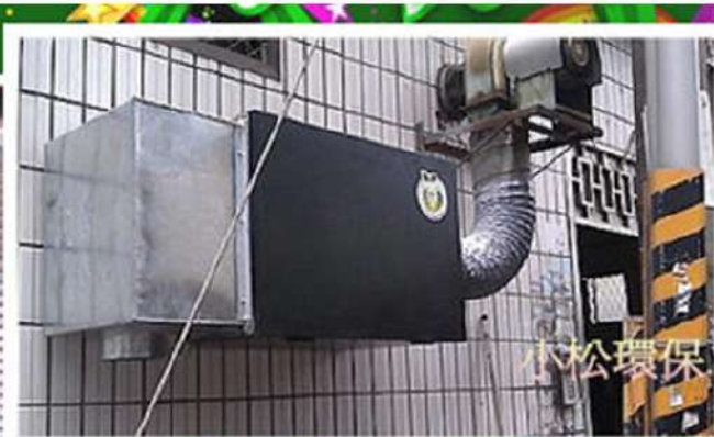
成功案例: 水煎包 施工項目: TF型油煙異味處理機
